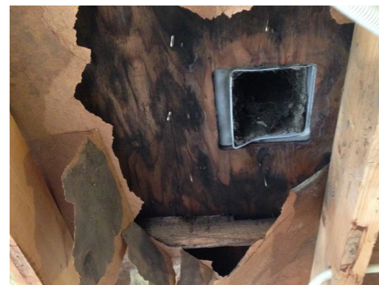
Rådden træ i tagkonstruktion.
